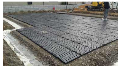
▲戸建建設時の基礎地盤で使用しているスーパージオ工法
