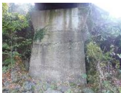
▲橋梁 ひび割れ補修施工前
