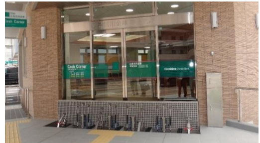
▲金融機関の玄関口に設置される 水道水圧シリンダー式防水板
