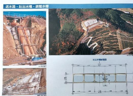
▲湖北揚水機場から送水する 管路・吐水槽施設
