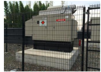
▲同ミュージアムの非常用長時間型防災用発電機化器機
