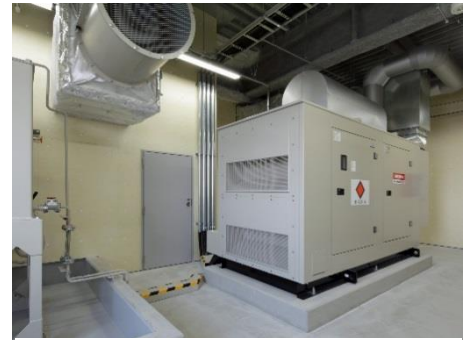
▲非常用発電機
