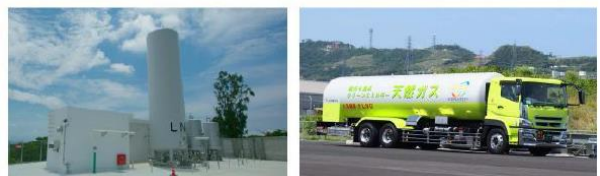
▲LNG サテライト設備と輸送するタンクローリー
