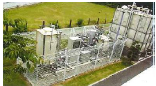
▲地下水膜ろ過システム
