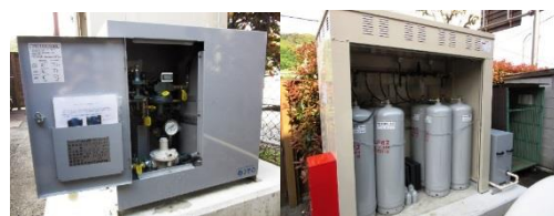
▲PA ジェネレータープロパンガスの備蓄
