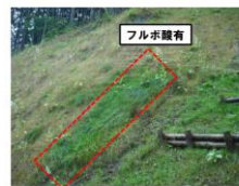
兵庫県 緑化成績不良である植生マット（肥料袋付き）へのフルボ酸を用いた吹付
