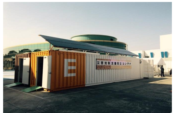
▲ソーラー発電を備えた災害時電源設備コンテナ
