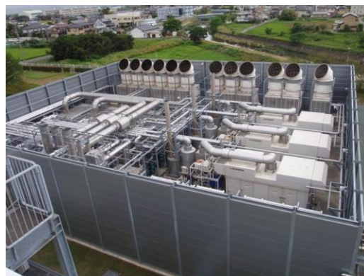
▲ガスコージェネレーション設備
