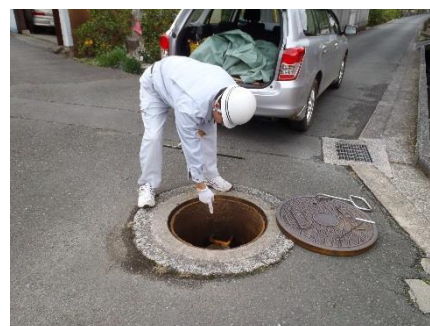
▲漏水確認状況
