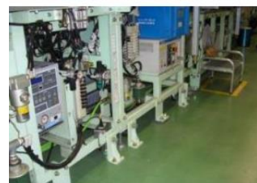
▲倒壊対策した機器類
