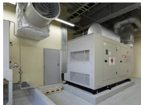
▲非常用発電機
