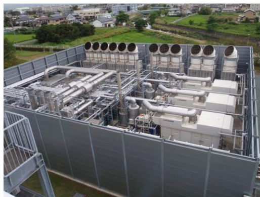
▲ガスコージェネレーション設備
