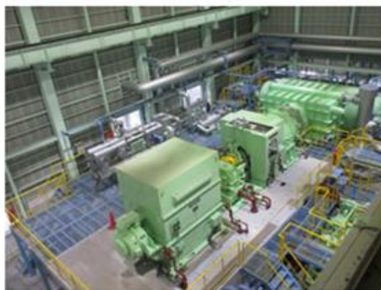
▲排熱発電設備 タービン発電機
