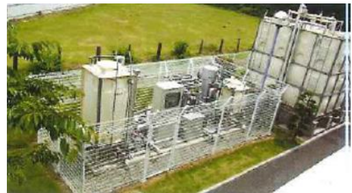
▲地下水膜ろ過システム
