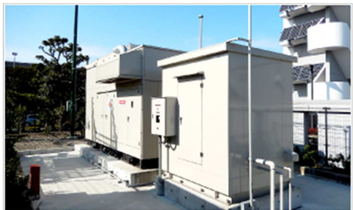
▲ 足立トラックターミナルの非常用自家発電設備
