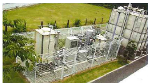
▲地下水膜ろ過システム
