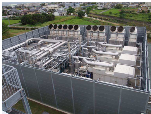
▲ガスコージェネレーション設備
