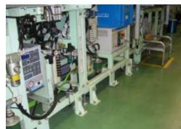
▲倒壊対策した機器類
