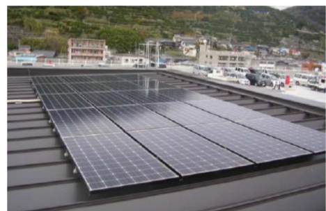
▲減災型ソーラーパネルの設置
