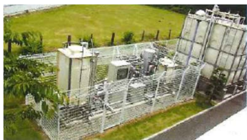
▲地下水膜ろ過システム
