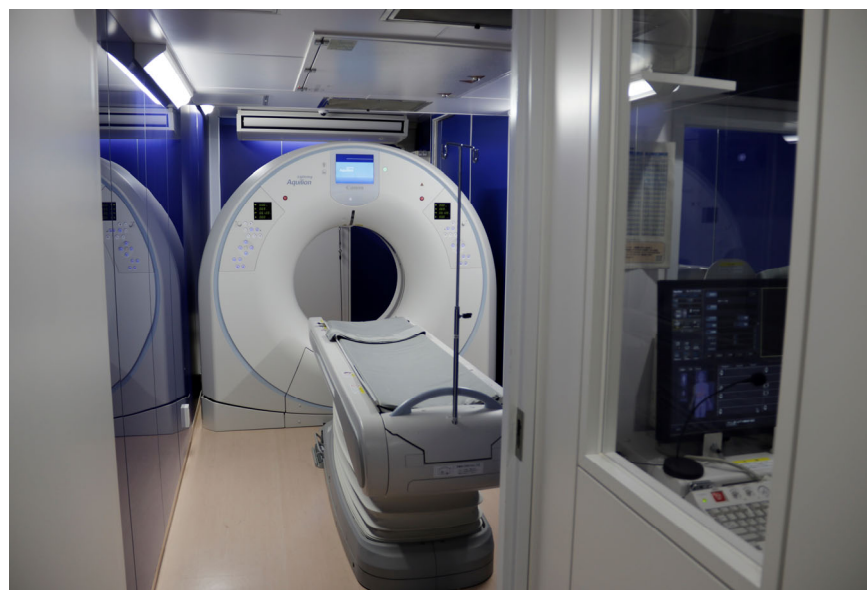
CTコンテナ内部
