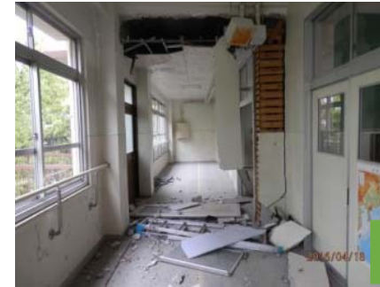
老朽化により天井や壁の一部が落下
