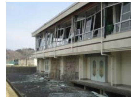
地震によりガラスが落下
