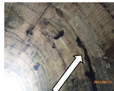
ひび割れの発生
