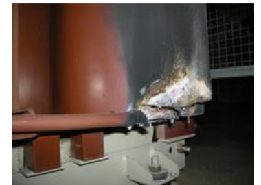
変圧器の発火による損傷
