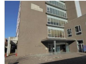
外壁の剥離、落下
