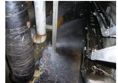
配管の破損による水漏れ
