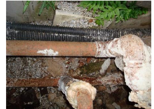
排水設備 (劣化状況)
