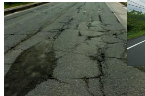
アスファルト舗装ひび割れ
