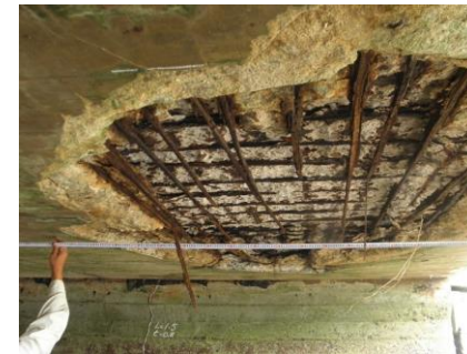
床版鉄筋露出
