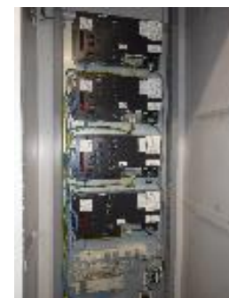
照明制御設備
