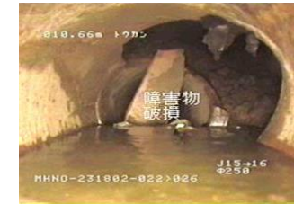
破損した管路
