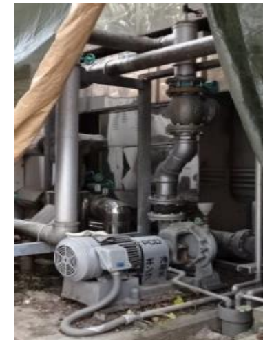
空調設備 (劣化状況)
