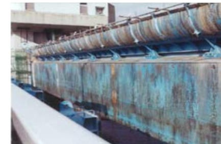
水門(ゲート塗装の劣化)
