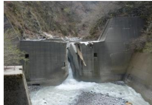
常時流水の影響による摩耗の進行
