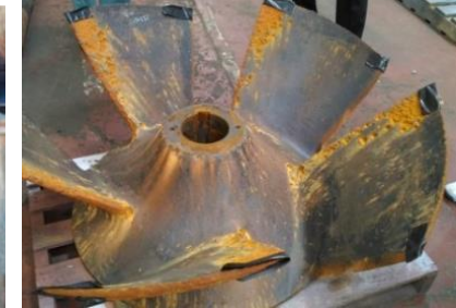
排水機場(羽根車の劣化)
