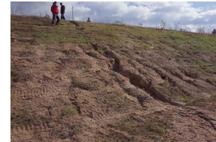
堤防(法面の浸食)
