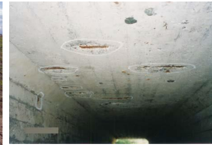
樋門・樋管(鉄筋の露出・腐食)
