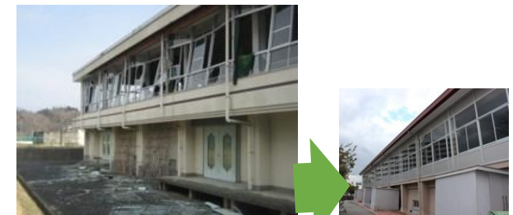
地震によりガラスが落下
