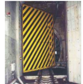
防水扉(トンネル内)
