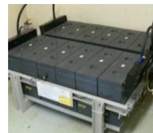
蓄電池の増設
