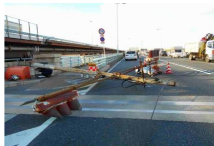
倒壊した信号柱
