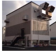
非常用自家発電設備のイメージ
