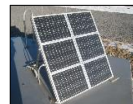
▲太陽電池パネル
