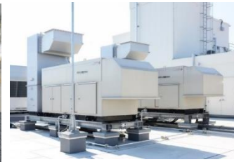
電源設備の高層階設置
