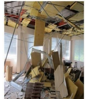
耐震化が完了した建物でも天井材落下など非構造部材の被害が発生
