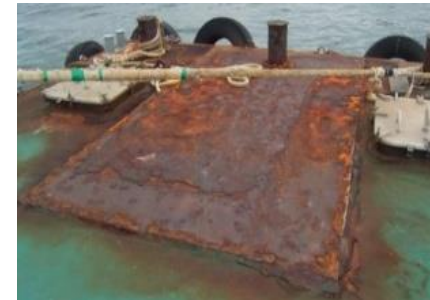
浮棧橋（係船柱部分発錆）
