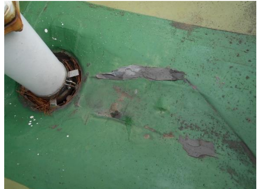
管理棟屋上の防水層の劣化
