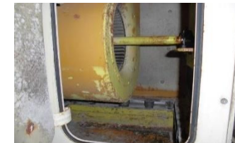
錆で老朽化した給気ファン （空調設備の更新： コロナ感染拡大防止対応）
