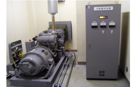
非常用発電機
