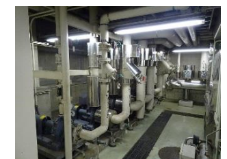
配管設備 （設備の故障による更新）
