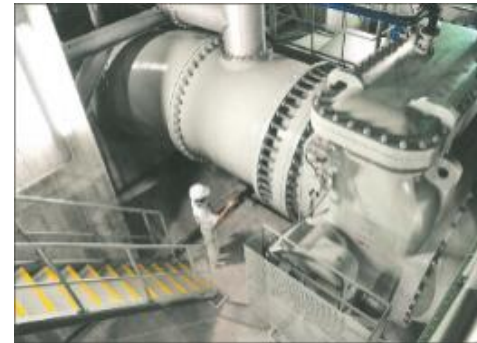
雨水ポンプの整備
