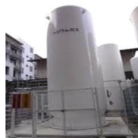
設備例: ヘリウム液化装置
