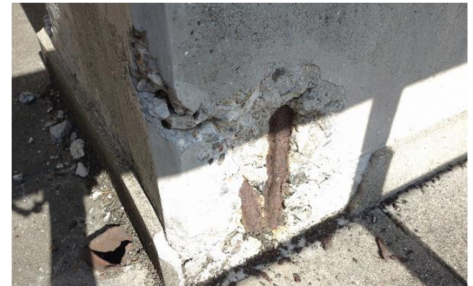
外壁のひび割れ状況の例
