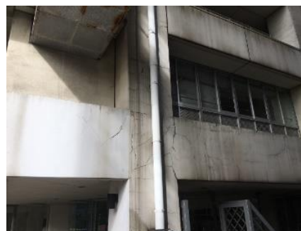
外壁の剥落・落下
