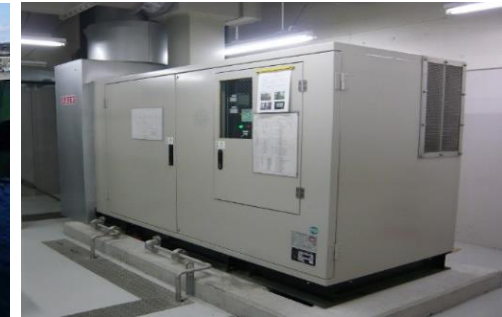
非常用発電機（イメージ）
