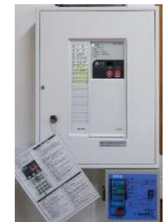
自動火災報知設備 （受信機）
