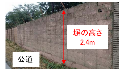
・塀の高さが基準高さ(2.2m)を超えている
