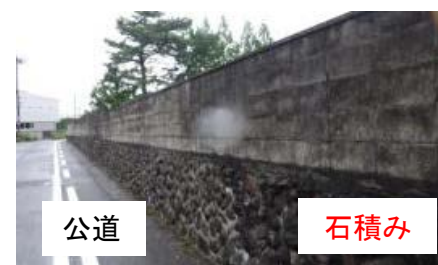
・石積みの上にブロック塀を積んでいる
