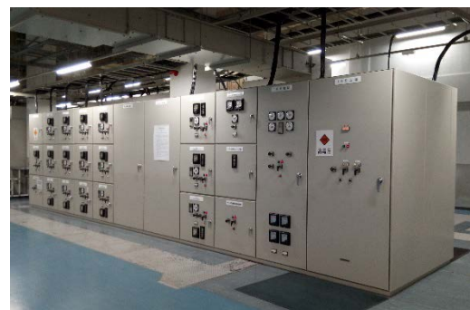
<管制施設の電源設備>
