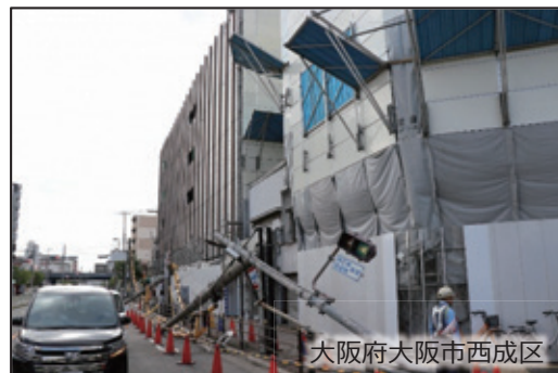
【H30台風21号による電柱倒壊の例】
