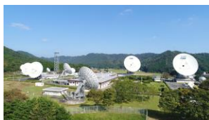
衛星通信システム の地上設備
