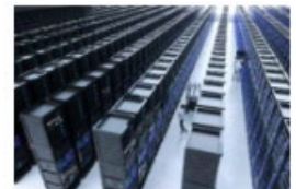
データセンター
