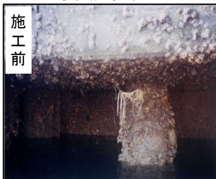
鋼管杭が塩害により腐食
