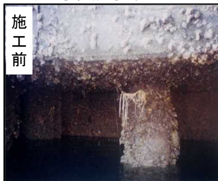
鋼管杭が塩害により腐食
