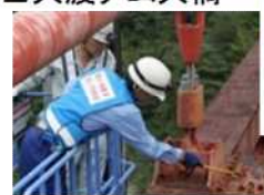
ケーブルの力 バー部の腐食
