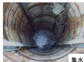
集水井内の劣化
