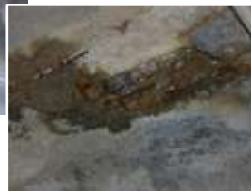
覆工コンクリートの剥落・貫通びわれ
