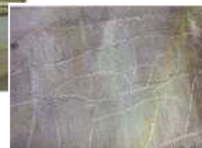
下部工のひび割れ
