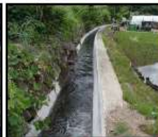
老朽化した用水路の整備・更新
