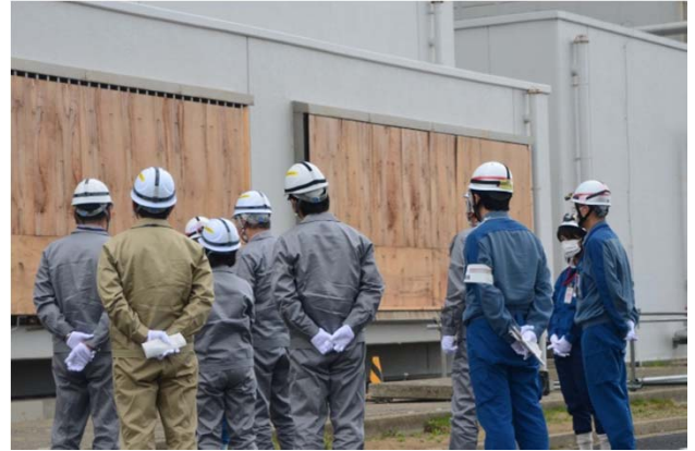
福島第二原発で津波による海水が流入した ディーゼル発電機の空気取入口
