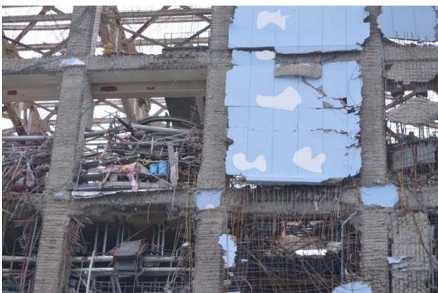
損傷した福島第一原発4号機原子炉建屋
