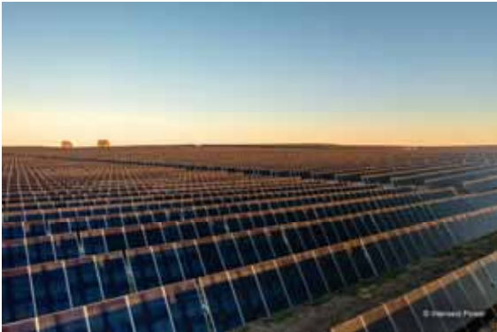
(出所) Intersect Power社HPより抜粋
