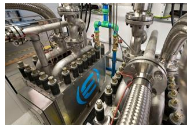
水素製造装置
