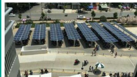
都市間連携を通じた太陽光・省エネ設備の複合導入
