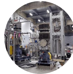
UNITY-2 （トリチウム燃料サイクルシステム）
