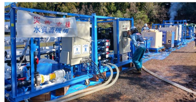
▲可搬式浄水施設（施設Ⅰ）の全景
