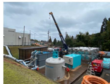
▲浄水場での活用(珠洲市) 施設Ⅱ
