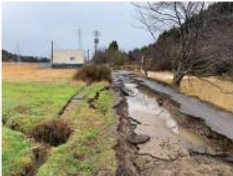
水源から浄水場へ送る導水管の被災（珠洲市宝立浄水場）
