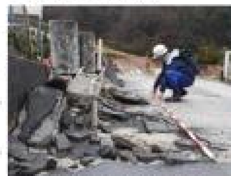
岩屋浄水場の被災（七尾市）
