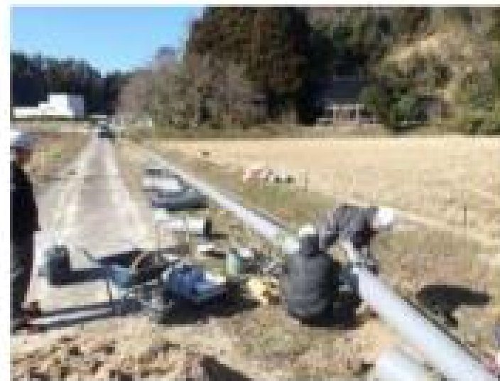
区域の下水を集約し処理場へ送る圧送管の被災（珠洲市熊谷ポンプ場）
