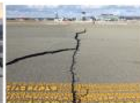
能登空港の被災（穴水町）
