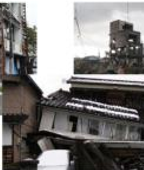
木造建築物の倒壊状況（穴水町）
