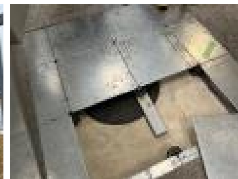
建物地下に設置された雨水貯留槽
