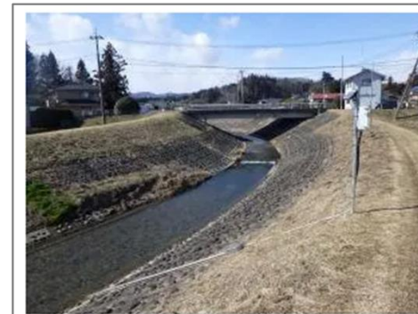
危機管理型水位計 設置例 (七北田川水系西田中川)
