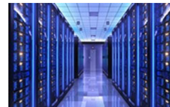
データセンター
