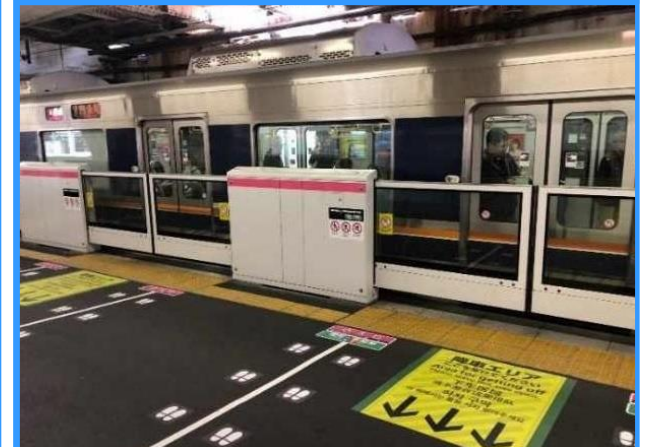
ホームドア・可動式ホーム柵整備
