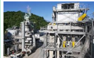
鶏糞燃焼発電ボイラー
