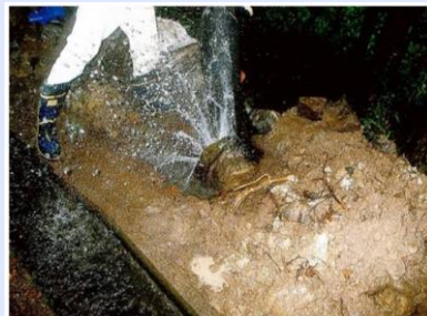
※地震による水道管の被害の例 (出典：国土交通省HP)
