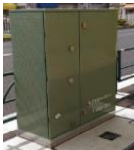
配電地上機器
