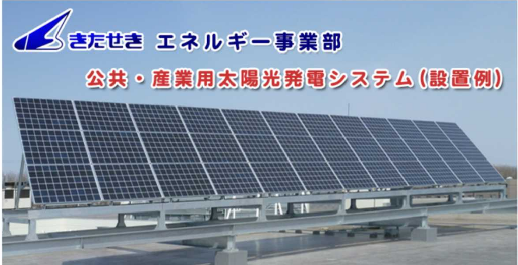
公共・産業用ソーラー発電システムの設置例 (札幌ドーム、北見信用金庫本店等に設置)
