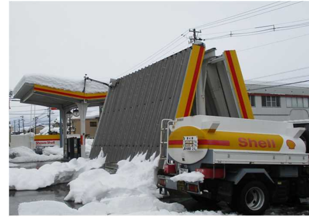
雪の重みでキャノピーが真っ二つに折れ、一時営業停止に追い込まれた S S （1月12日富山市内）
