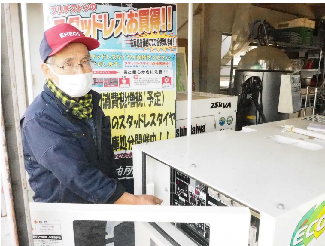
住民拠点 S S であるオカダ石油ガス貝田 S S では、周辺地域一帯が停電となったため、急きょ、自家発電設備を稼働させ、深夜から燃料供給を再開し、地域住民らの給油要請に応えた（2021年2月14日撮影）
