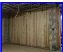
(株)竹中工務店新倉竹友寮 寮(耐震補強) (H26.12竣工) 埼玉県和光市 5階建て・1棟(ただし、耐震補強は 1階食堂において実施。)
