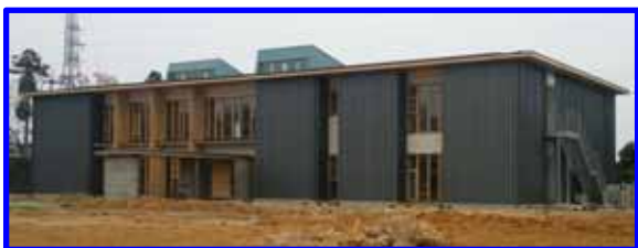
高知県森林組合連合会 事務所 (H28.1竣工) 高知県南国市 2階建て・1棟
