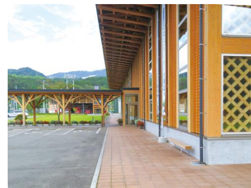
深い軒により雨落ちとなる位置を外壁から離すとともに、基礎高さを上げて雨水の跳ね返りが作用しにくくした事例
