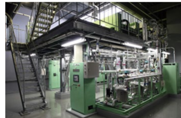
【臨界抽出プラント装置】
