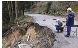
危険箇所での被災状況調査
