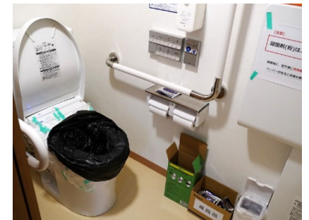
災害用トイレ使用訓練
