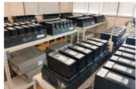
ドローンのバッテリー充電施設
