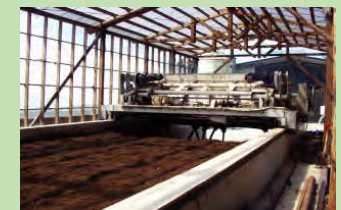
良質な堆肥を供給する堆肥化处理施設
